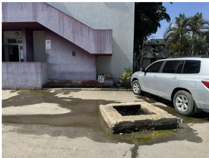
Figure 9: Insuffisances du système de drainage pluvial après de fortes précipitations.
